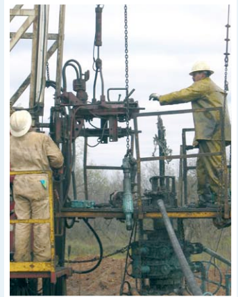
Här pågår renovering av en gammal brunn i östra Texas. Man ersätter alla gamla sönderrostade rör med nya friska rör.
